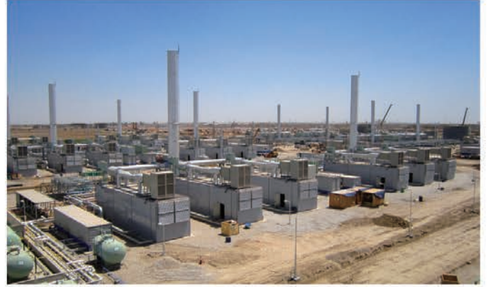
IRAQ MOE 900MW SITE PJT
